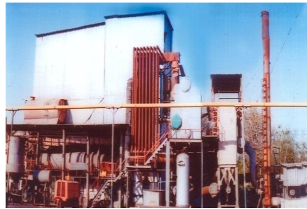
Рисунок 3 - Общий вид пилотной установки
